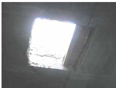
Absence de grillage au lanterneau
