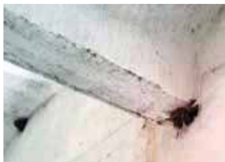
Nid d'oiseaux au plafond du bâtiment !!
